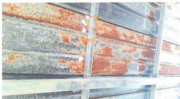
Foto 4: Del lado izquierdo las laminas tambien se encuentran totalmente dañadas.
