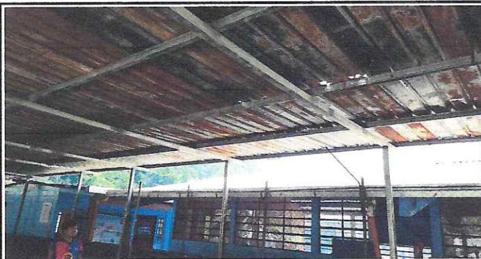
Foto 1: La mayor parte del entechado se encuentra agujerado y al llover provoca la acumulación de agua en el patio escolar.
