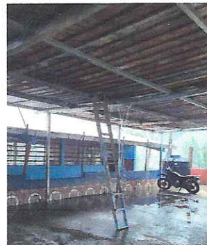
Foto 2: El techo esta completamente vencido hasta la aparte de abajo, unicamente la escalera le sirve de soporte.
